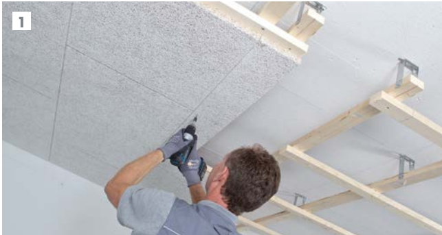
1 Remplacement du cadre de plafond pour l'installation des luminaires de cadre: Mettre des lattes porteuses et suspentes supplémentaires dans la zone du remplacement.
